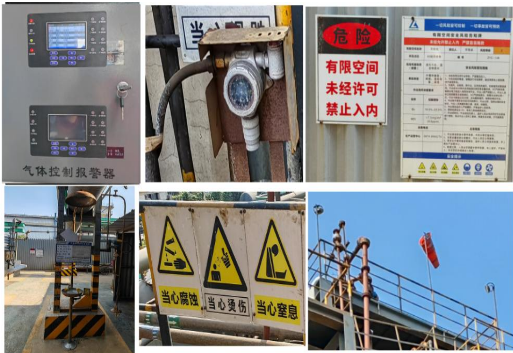
现场安全设施（部分）
