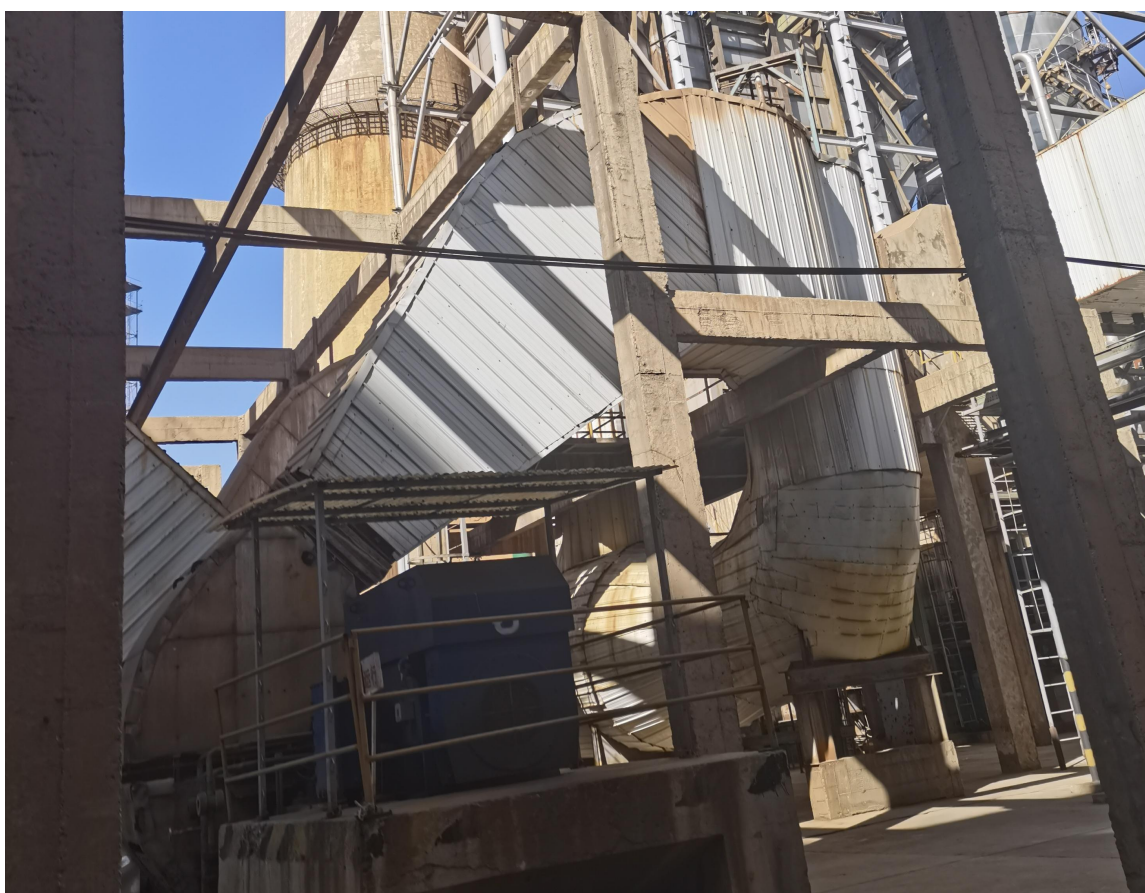
图 F1-2 原有脱硫装置（新建脱硫装置北面）
